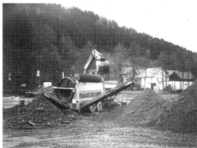
Bild 4 Sieben und Konditionieren mittels Drehtrommelsieb
