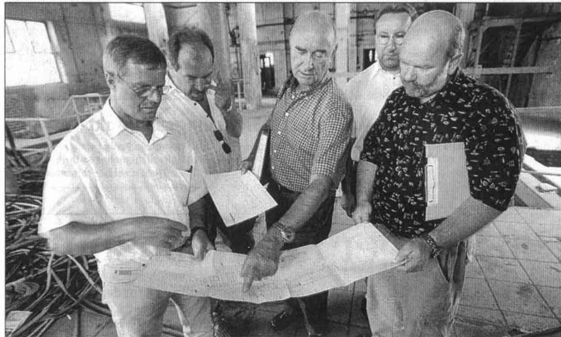
Machen sich im Hydraulik-Abrissgelände ein Bild über die bevorstehenden Arbeiten: Wolfgang Marr, Geschäftsführer der Zella-Mehli-er SGDA (l.), Dr. Jürgen Blaudszun, Geschäftsführer der Geocontrol GmbH Gera (3. v. l.), Jörg Richter von der Stadtverwaltung Rochlitz (2. v. r.) und Peter Trost, Geschäftsführer der Sondershausen Recycling GmbH (r.).
